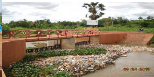
Passé bouchée par les ordures
